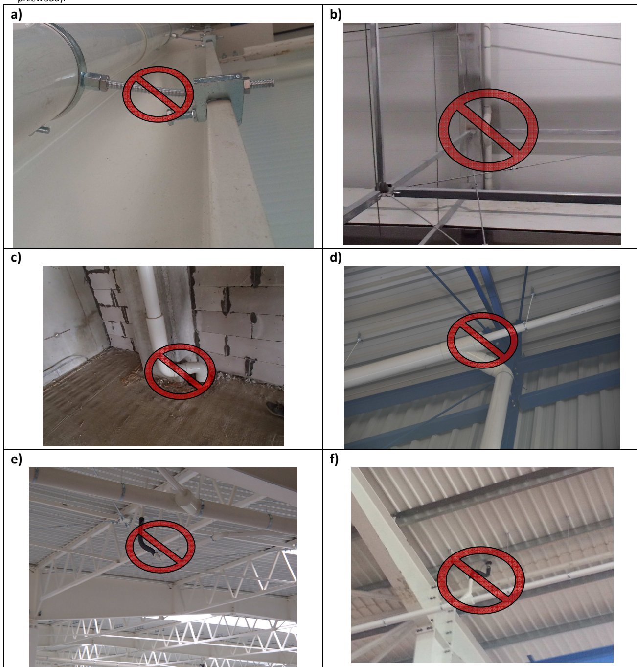
Ryc. 8. Przykładowe błędy wykonawcze - a) wygięte pręty mocujące; b) Ominięcie stężenia dodając kolana; c) pion kanalizacyjny zakończony kolaniem przed miejscem rozprężenia; d) nieprawidłowe wpięcie się trójnikiem do pionu kanalizacyjnego; e) podłączenie przewodu elastycznego poprzez kolanko (powstanie syfonu); f) wpięcie przewodu elastycznego pionowo do instalacji (powstanie syfonu oraz nieprawidłowa praca przewodu).
